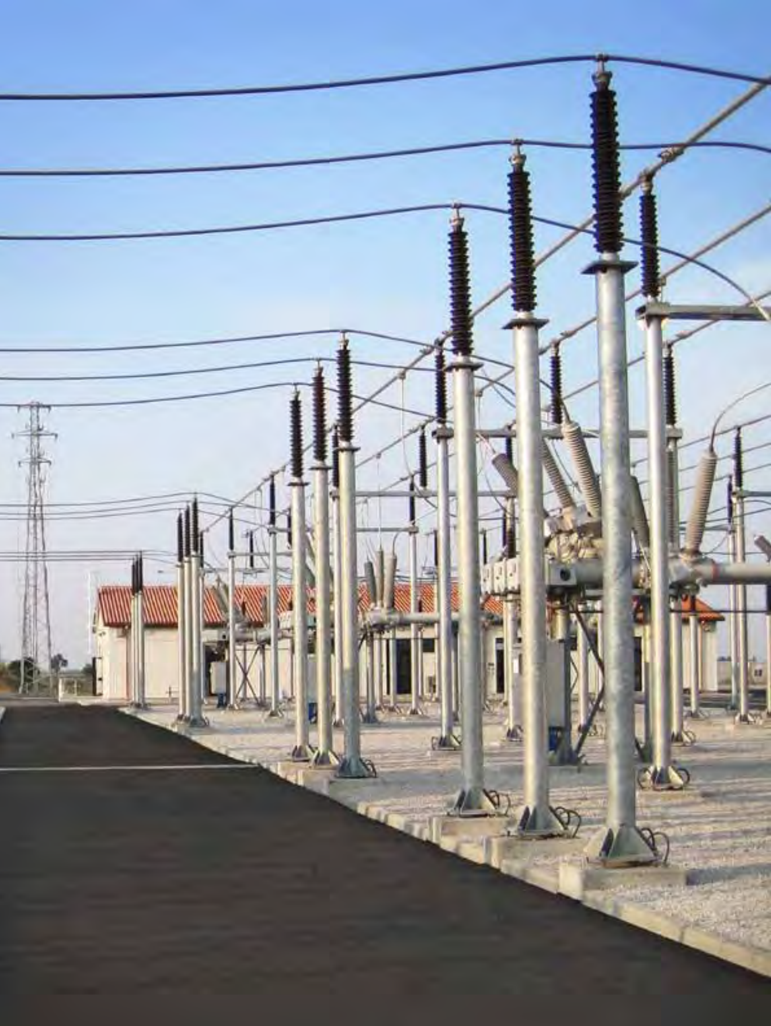
UMSPANNWERK DER FREIFLÄCHENANLAGE SERENISSIMA, CANARO, ITALIEN, 48 MWP
